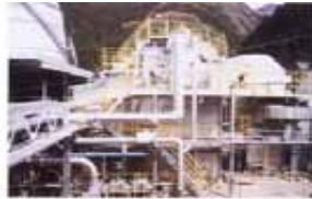
木くずだきボイラー
